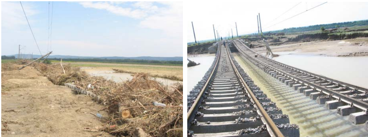
Figura 34: Distrugerea infrastructurii feroviare pe cca 2 km
