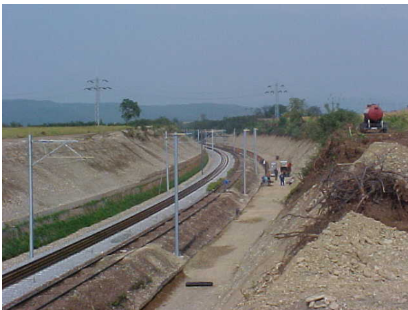
Figura 22: Taluze abrupte armate km 86+900 - 87+400 septembrie 2002
