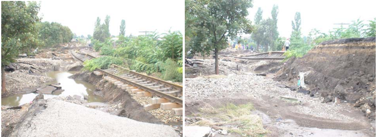
Figura 37: Distrugerea liniei c.f. între km 252+400 - 252+550
