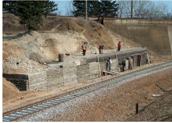
Figura 19: Zid debleu km 57+400 – martie 2003
